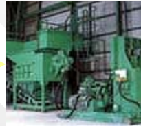
破砕施設(中間処理)
