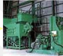
破砕施設(中間処理)
