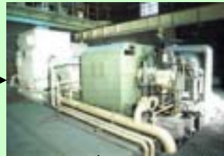
タービン発電機
